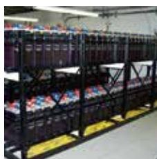
サーバー電源
