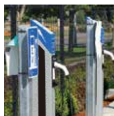
DC充電ステーション
