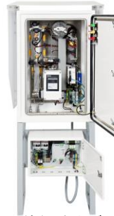
絶縁油中ガス・水分オンライン監視装置
